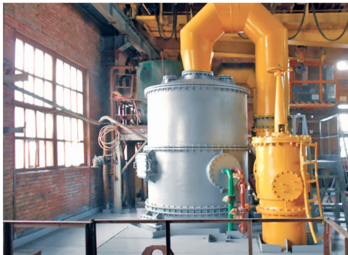
Промыватель газа содовых печей – холодильник газа содовых печей в отделении АБДСКБ № 1 цеха кальцинированной соды № 1
