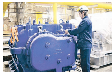
Начальник машинного отделения Максим Югов демонстрирует новое оборудование, к монтажу которого уже приступили подрядчики
