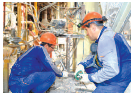
Замена запорной арматуры на воздушном коллекторе в отделении кальцинации цеха кальцинированной соды №2. На фото: Ростислав Титов и Сергей Чакилев, слесари по КИПиА РСМУ и цеха №12
