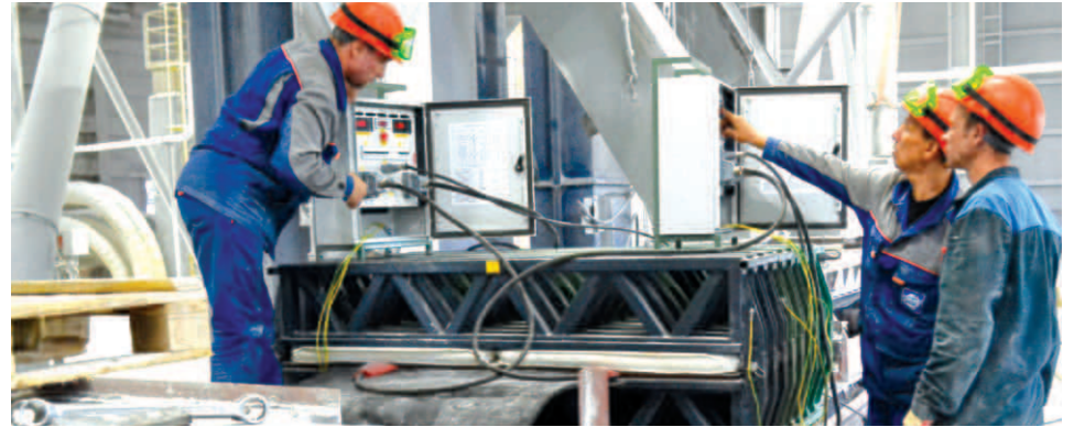
Новый вулканизатор при склейке конвейерных лент в отделении производства кальцинированной соды марки А испытали слесари-ремонтники РСМУ (на фото — слева направо): Андрей Усанин, Сергей Болотов и Андрей Топтыгин
