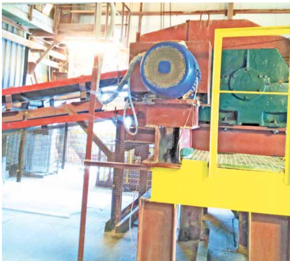
В ходе остановочного ремонта на одном из объектов цеха приготовления рассола заменен редуктор на конвейере № 3
