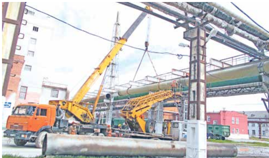
Модернизация газохода крепкого газа. Выполнен монтаж участка трубопровода из стеклопластика на фланцевых соединениях
